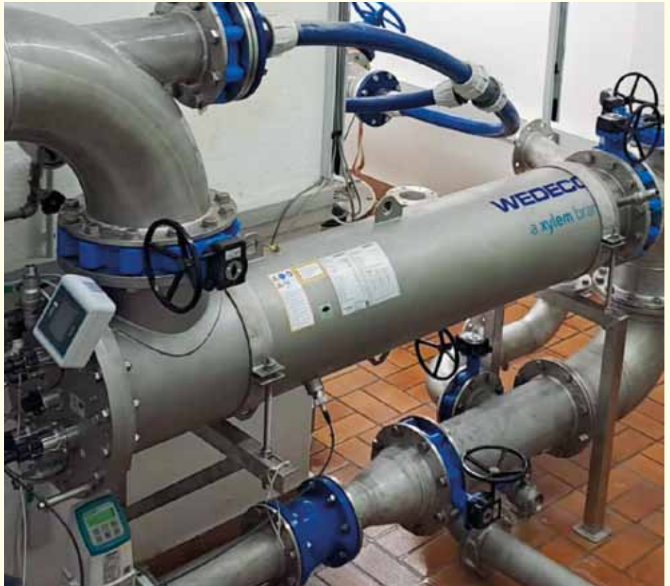
Neue UV-Anlage in der Wasserversorgung Amberg-Wiedergeltingen (Bild: Gemeinde Wiedergeltingen)
