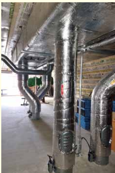
Zuluft in die Klassenzimmer (Foto: Gemeinde Wiedergeltingen)
