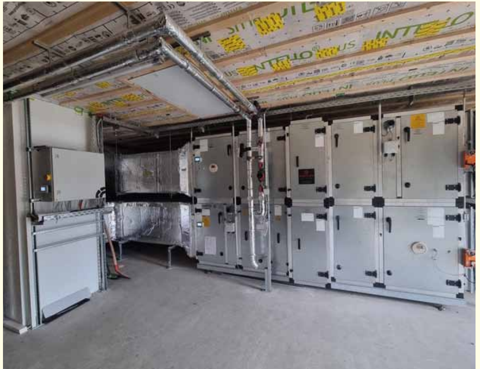
Das „Herzstück“ der Anlage auf dem Dachboden der Grundschule (Foto: Gemein. Wiedergeltingen)
